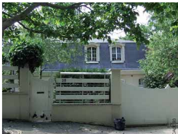
La clôture en PVC vieillit mal et est en rupture total avec les caractéristiques architecturales du quartier.
